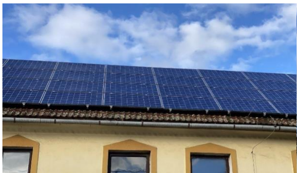
Fotovoltaika na střeše budovy
