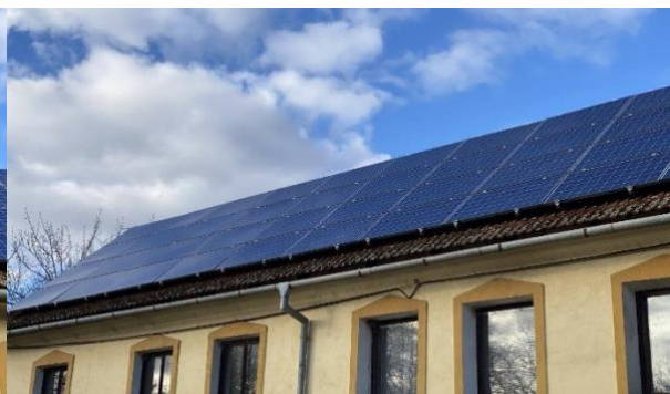
Fotovoltaika na střeše budovy
